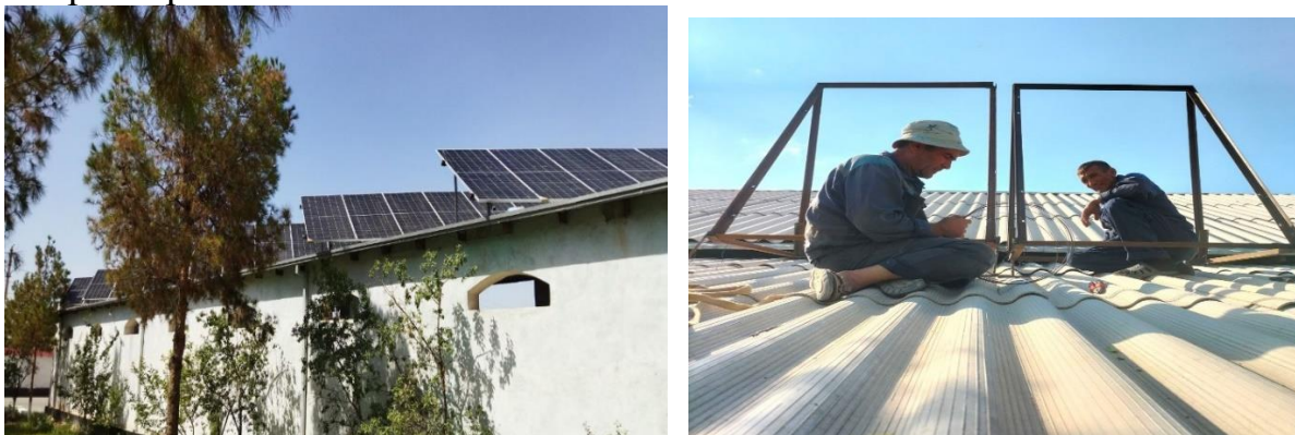
Рис. 3-4. Солнечная электростанция мощностью 30 кВт установлена для административного здания на территории Управления насосных станций и энергетики при Аму-Кашкадарьинском бассейновом управлении ирригационных систем
